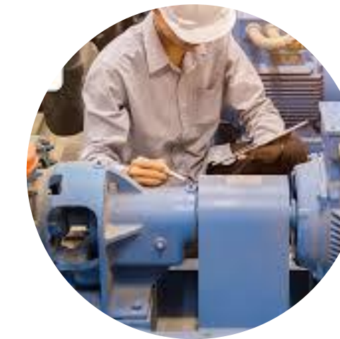
Bombas de Agua
